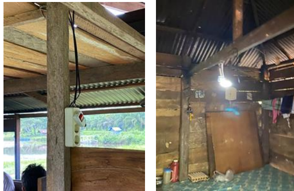
(a) (b) Gambar 8. Pemasangan stopkontak dan lampu di rumah warga, a) stopkontak di warung, dan b) lampu di rumah warga.
